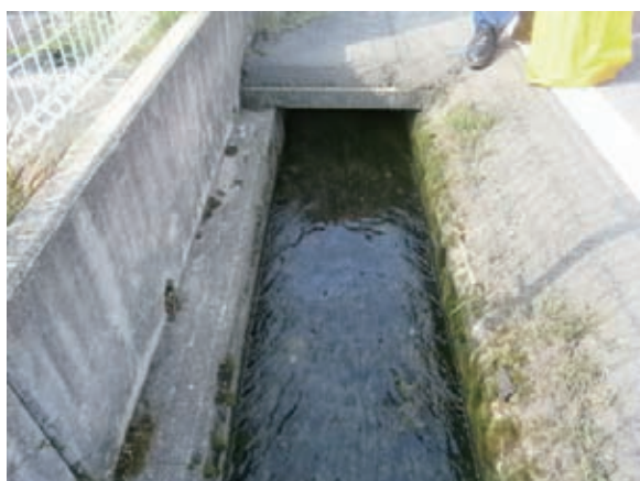
＜使用方法1「すのこ」設置前＞ 水深約20センチ 地物を利用して設置する 「すのこ」だけで堰止め可能
